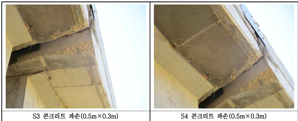
【사진 8.3.3】바닥판하면 손상현황
